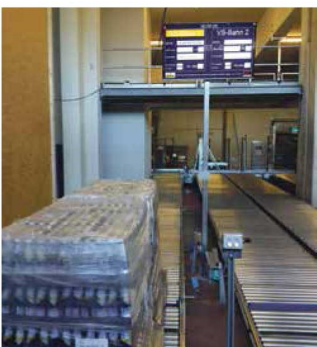
Kapazität: Pro Stunde können 120 Paletten ein- und 240 Paletten ausgelagert werden
